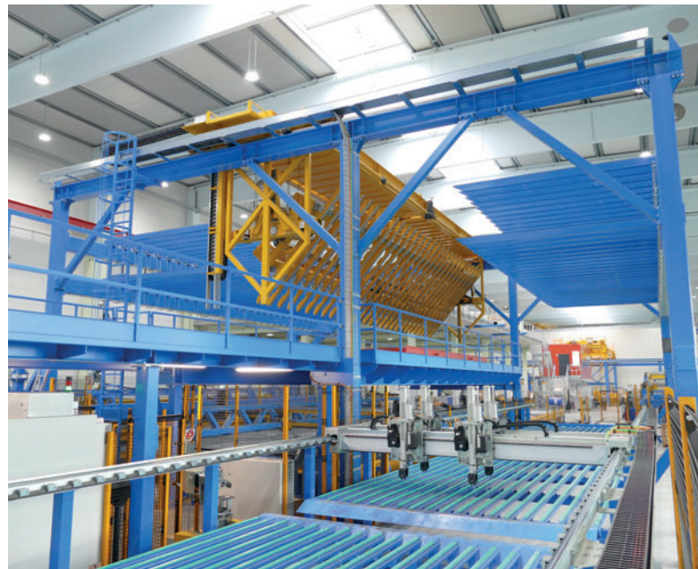
Die Magnettraverse legt die Matten nach CAD Vorgabe in die Paletten ein, bedient den Zwischenpuffer, kann Matten wenden, wenn sich Längsstäbe über den Querstäben befinden und legt Matten auf einen Stapelwagen ab.
